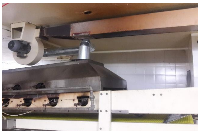
Figura 48. Adecuación del extractor al horno túnel.
