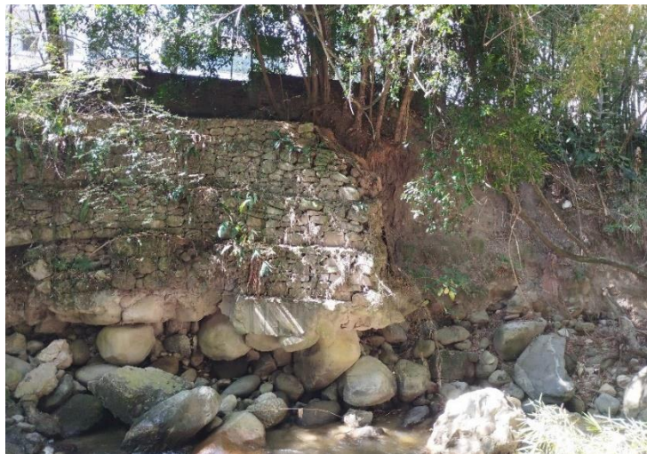
Figura 2 Socavación del Río Frío de los muros de contención– Fuente: Estudio CDMB
