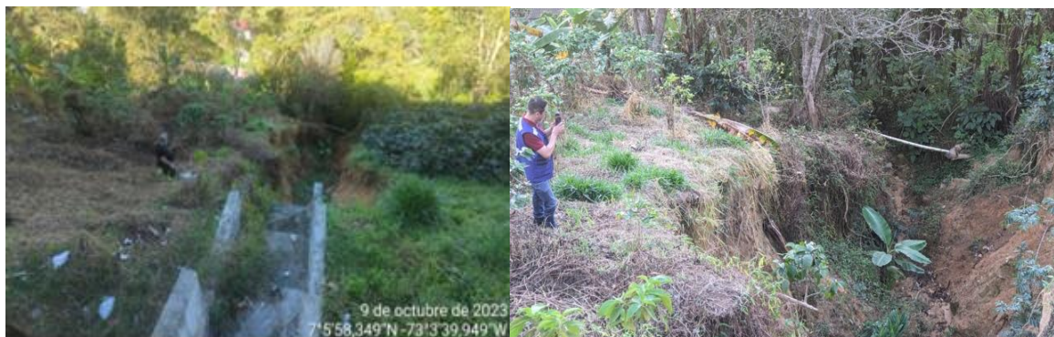
Figura 9 Estado actual de la obra de disipación de energía con socavación por paso de flujo) – Fuente: CDMB
