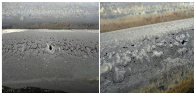
Figura 46. Corrosión bajo depósito
