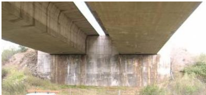
Imagen 14. Ataque de sulfatos en los estribos
