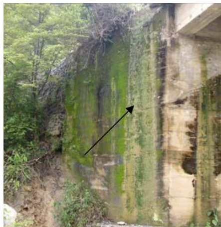
Imagen 16. Contaminación del hormigón por humedad. 2006
