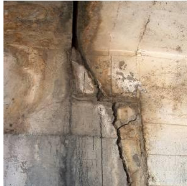
Imagen 15. Grietas presentes en los estribos de la superestructura
