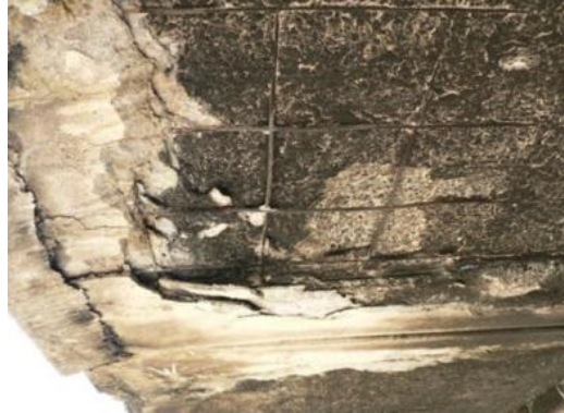
Imagen 18. Falla por temperatura
