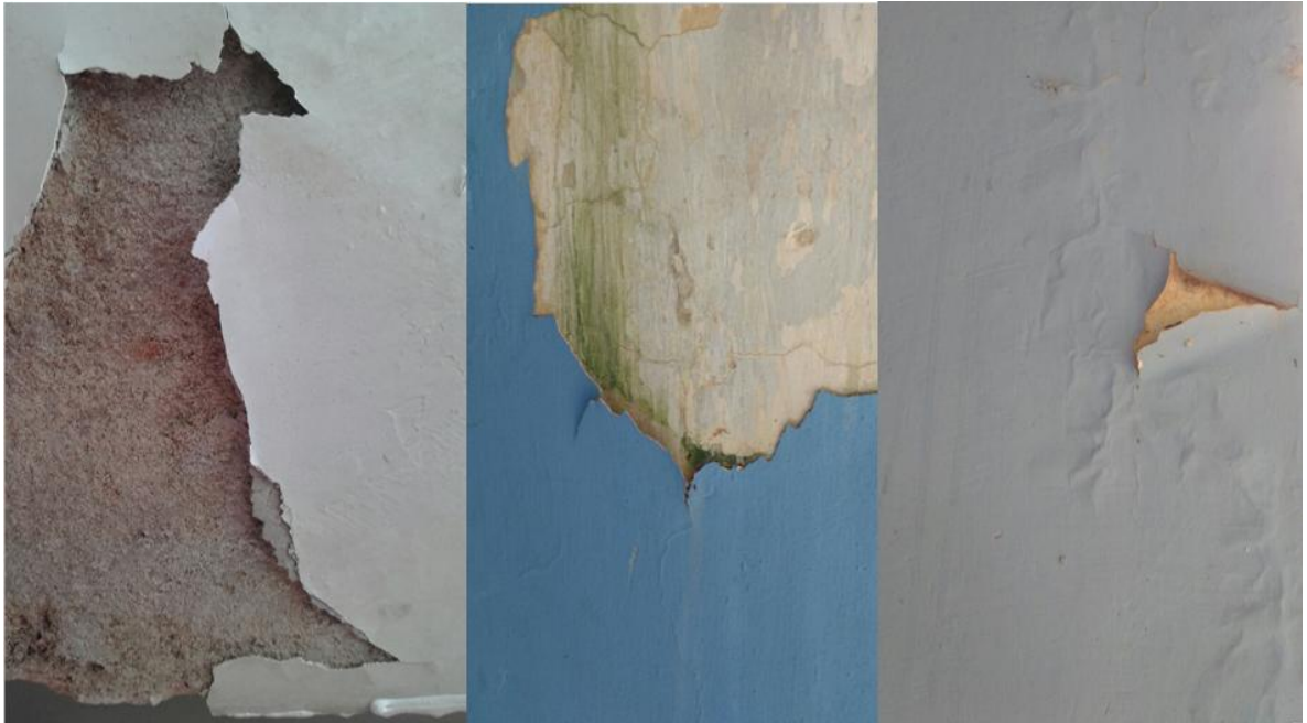
Figura 15. Grietas de humedad – Registro Fotográfico– 2016
