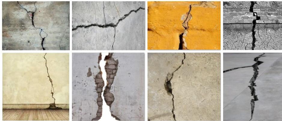
Figura 3. Exploración del comportamiento natural de una Grieta – Recopilación de imágenes.
