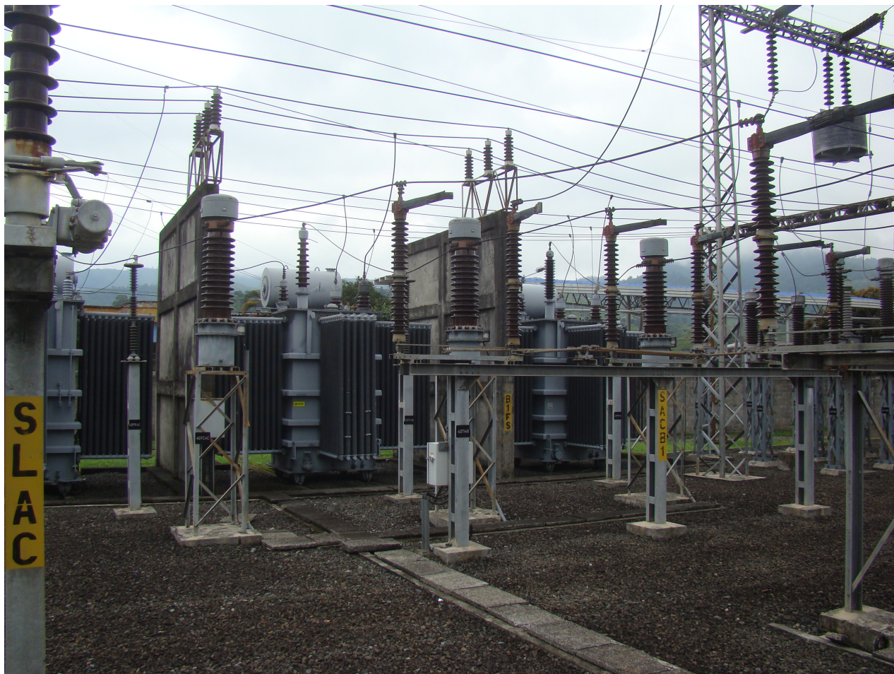
Figura 6 Subestacion eléctrica Empresa de energía eléctrica bajo estudio
