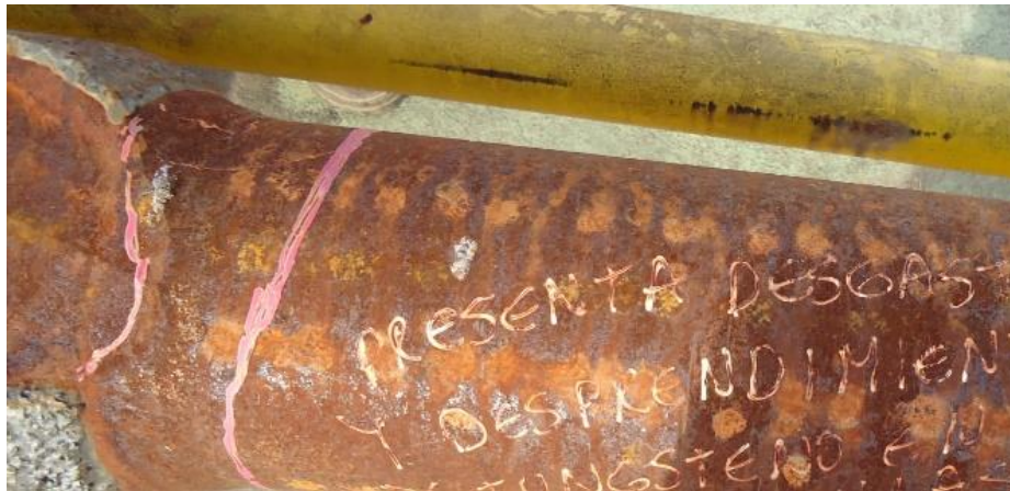
Imagen 66. Fisuras transversales y longitudinales en área del taper
