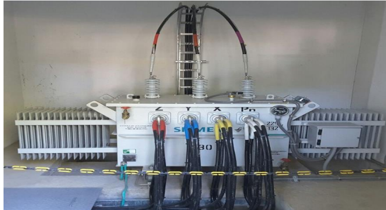
Figura 5. Transformador trifásico SIEMENS de 630 kVA.
