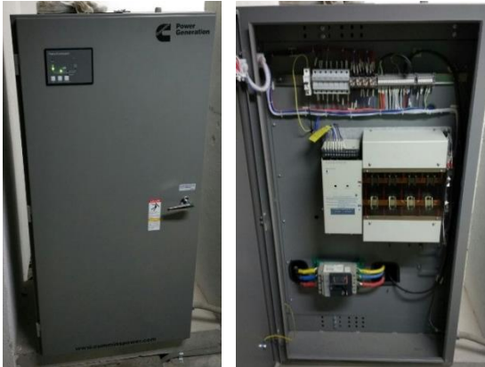
Figura 7. Transferencia automática de 800 A.
