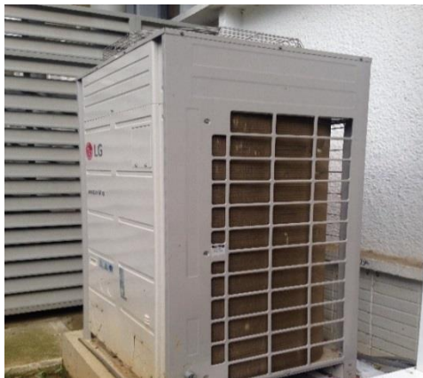
Figura 86. Unidad condensadora de aires acondicionados (tipo Cassette) sala individual.
