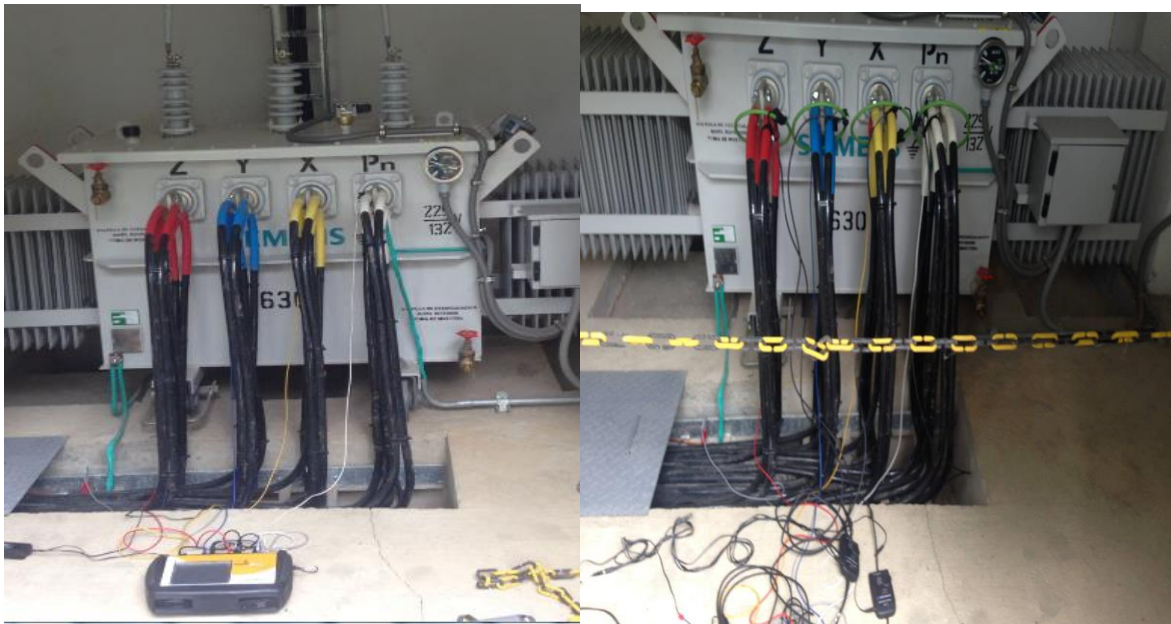
Figura 52. Transformador con el analizador de calidad de energía.
