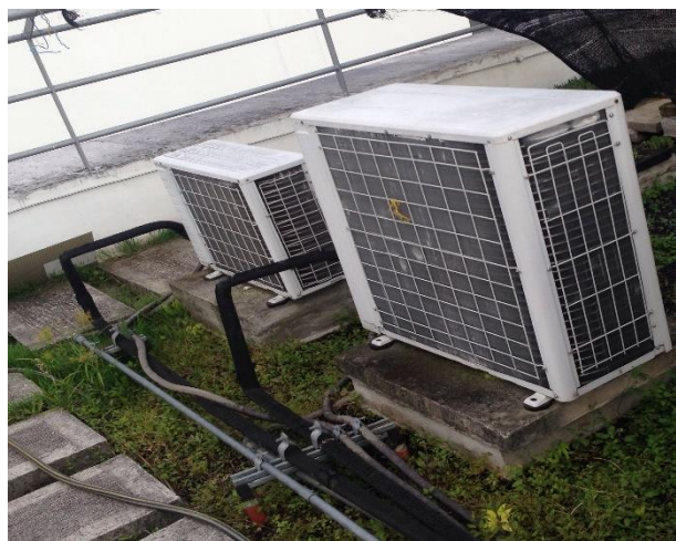
Figura 84. Unidades condensadoras de aires acondicionados (mini Split) del quinto piso.
