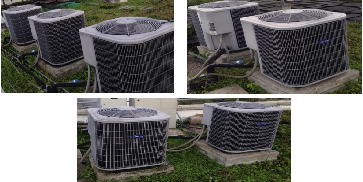
Figura 85. Unidades condensadoras de aires acondicionados (tipo Cassette) cuarto piso.
