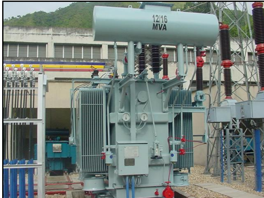
Figura 9. Transformador de potencia
