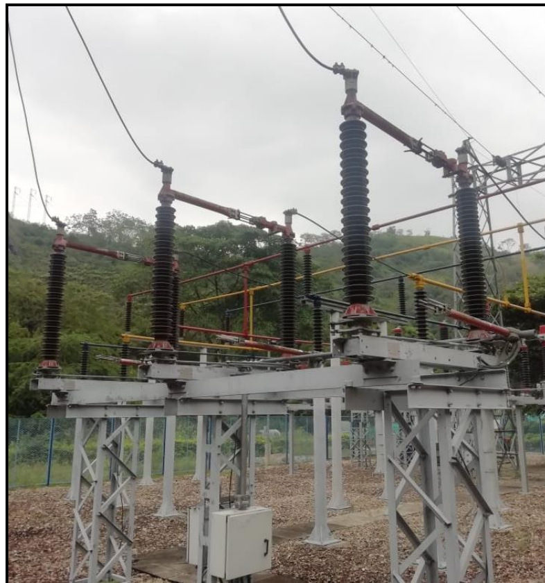
Figura 5. Seccionador de línea
