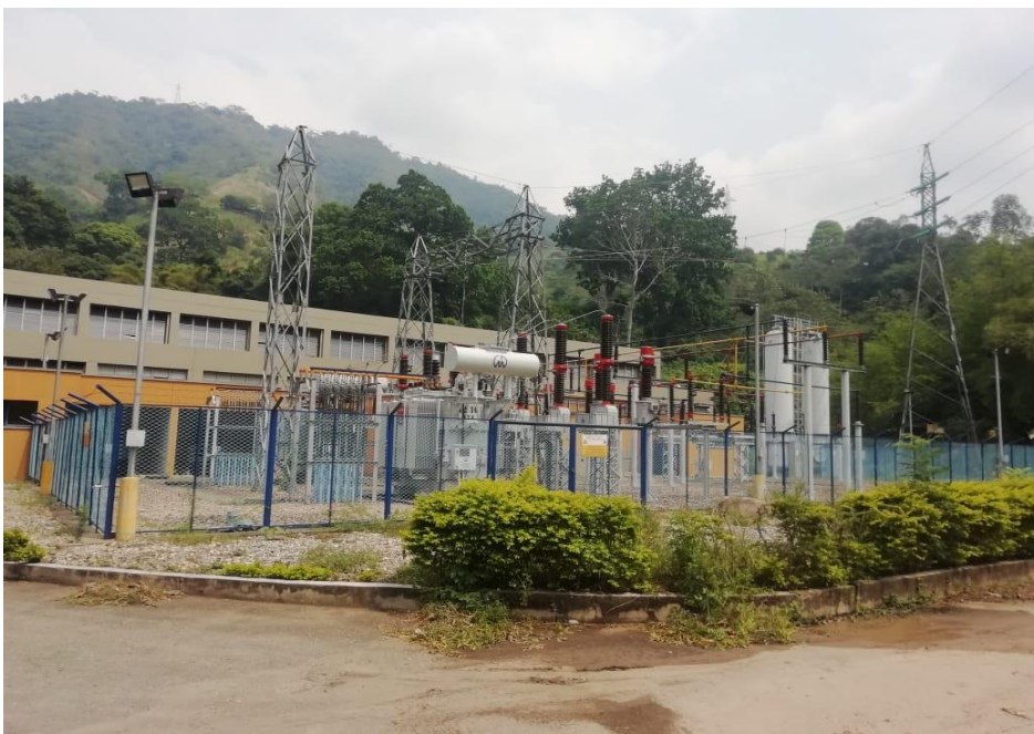
Figura 16. Subestación José Oscar Serrano Valero (Bosconia)
