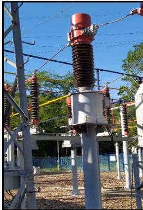
Figura 7. Transformadores de corriente
