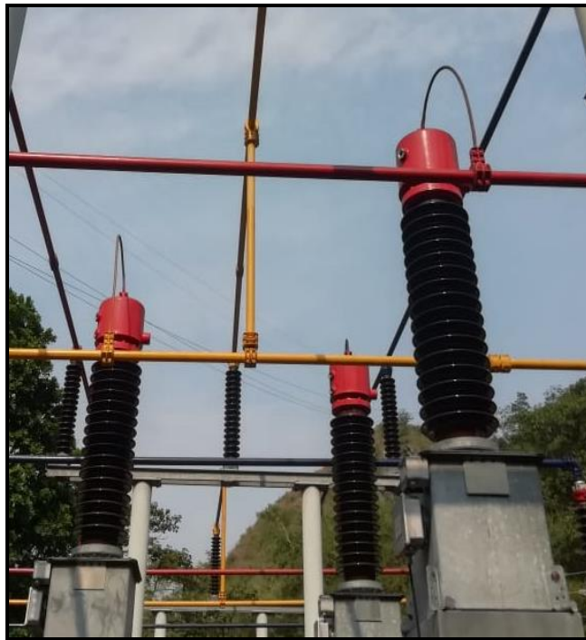
Figura 6. Transformadores de potencial
