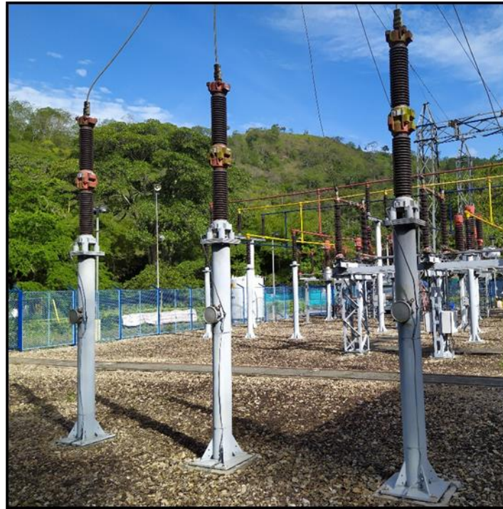
Figura 4. DPS de línea 115 [kV]
