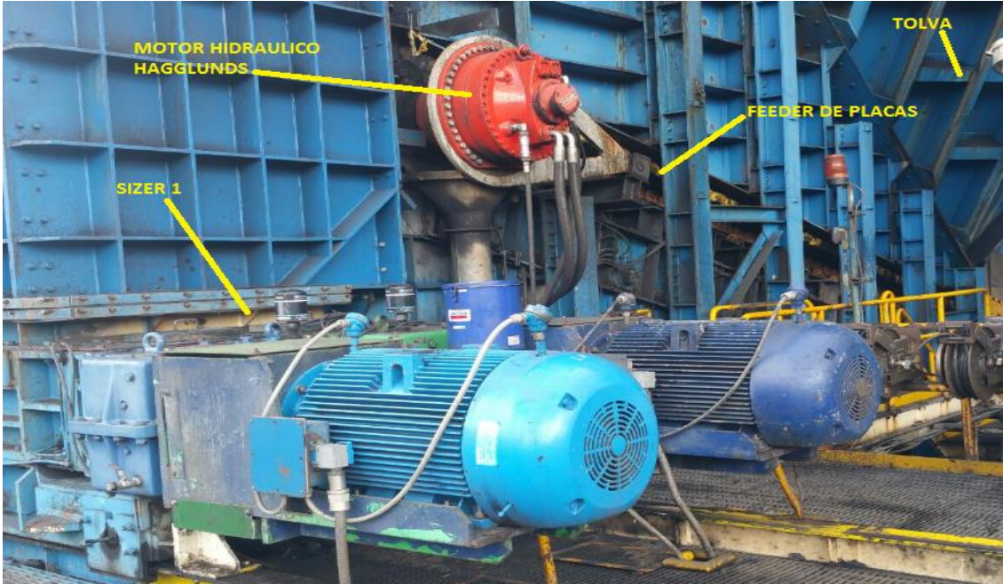
Figura 10. Primera etapa del sistema de trituración
