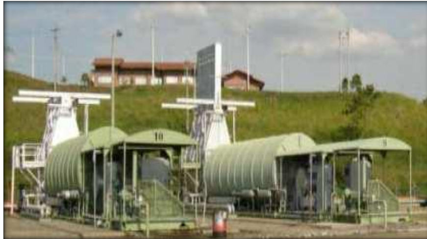
Figura 5. Generador de vapor estático
