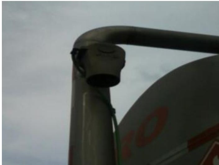
Figura 16. Desfogue del sistema de recuperación.
