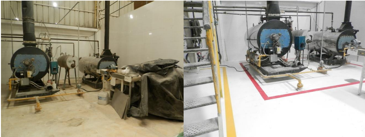
Figura 28. Calderas antes y después de la demarcación.
