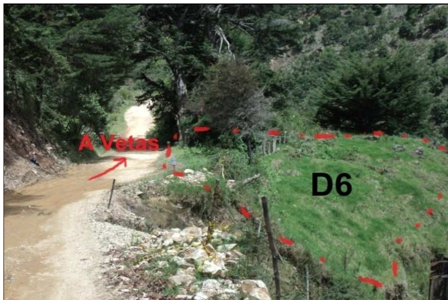
Figura 15. Geoforma desarrollada sobre el talud inferior de la vía.
