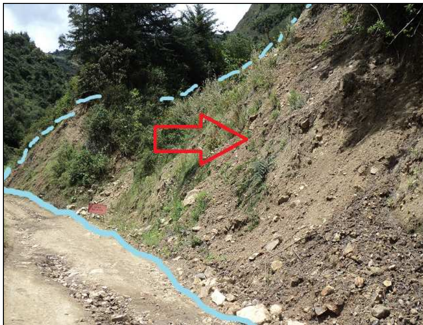
Figura 27. Evidencia de la erosión de tipo laminar en el sector 2
