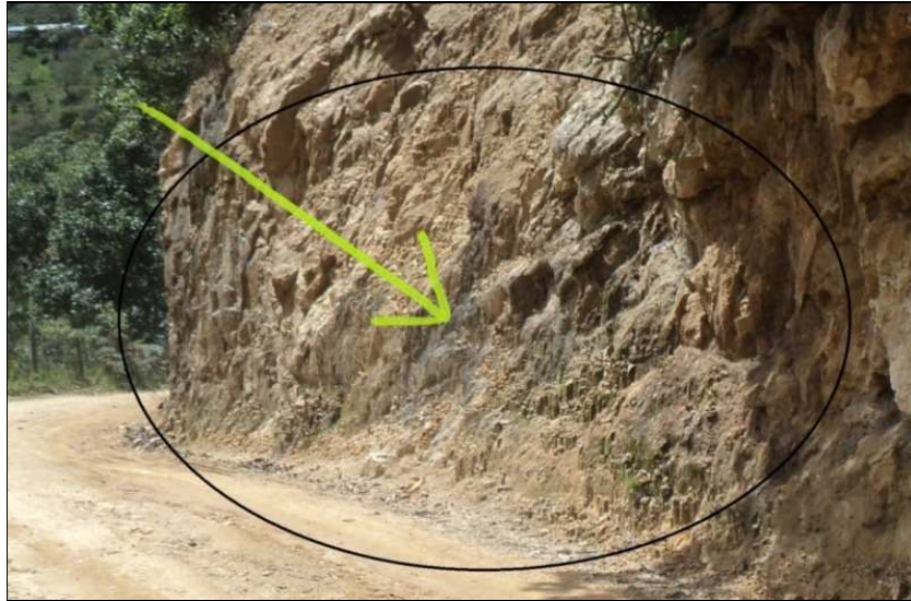
Figura 25. Erosión de Tipo Laminar sobre el talud superior de la Vía
