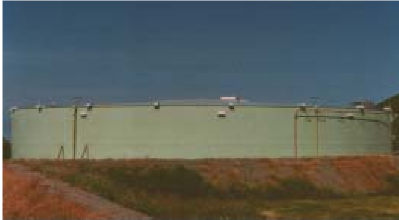
Figura 1 Tanque de Techo cónico. Estación de Puerto Salgar
