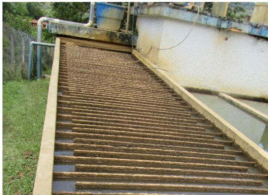
Figura 5. Canaletas de floculación
