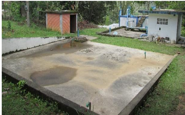
Figura 7. Tanque de Almacenamiento
