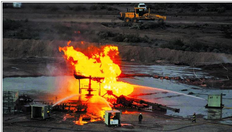
Figura 75. Surgencia de pozo.
