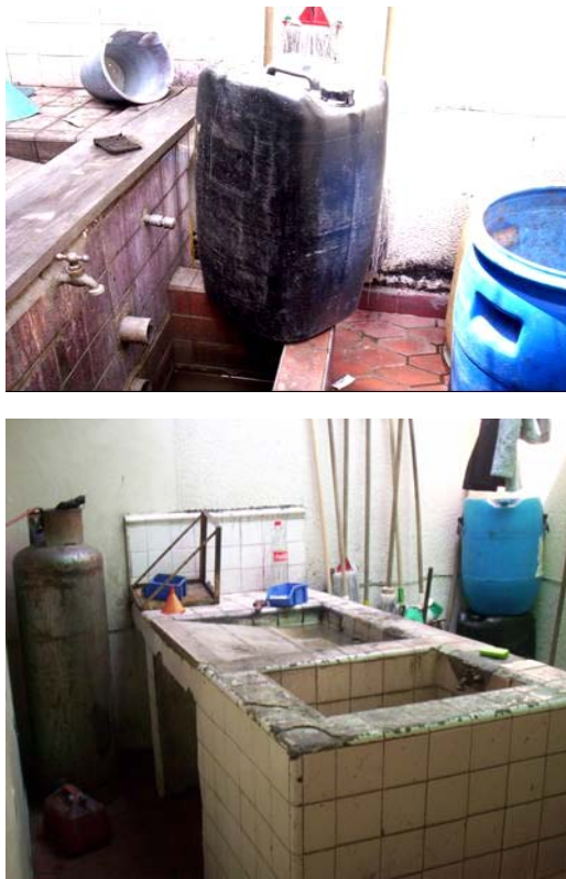
Figura 87. Lavadero Antes del Mantenimiento
