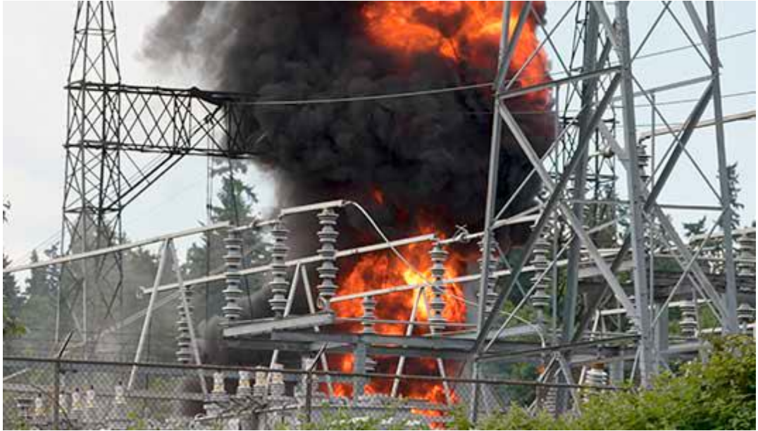
Fotografía 2. Fallas en los transformadores
