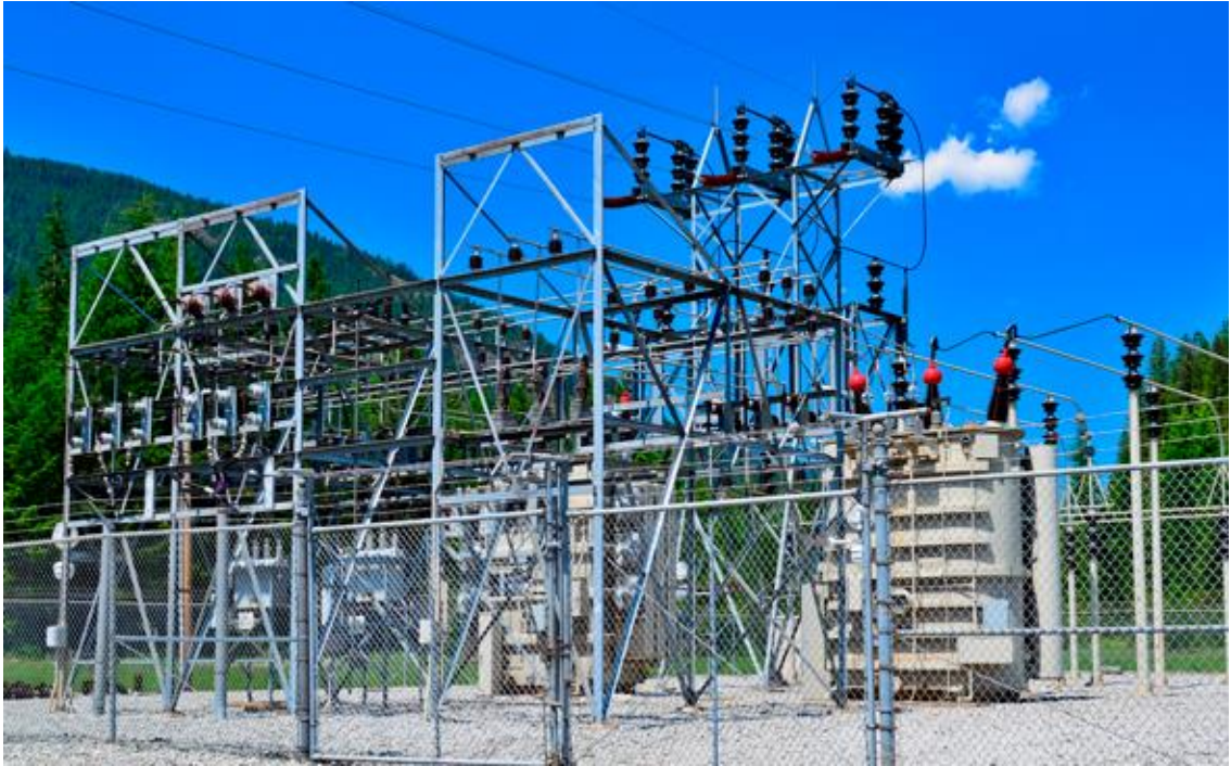
Fotografía 4. Subestación sin contacto de árboles.
