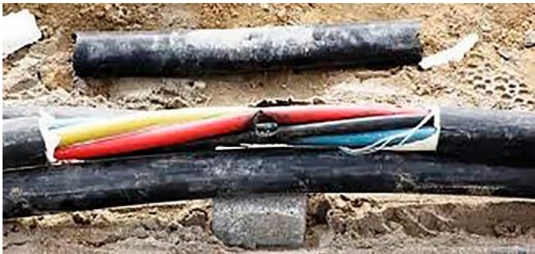
Fotografía 1. Cables bajo aislamiento
