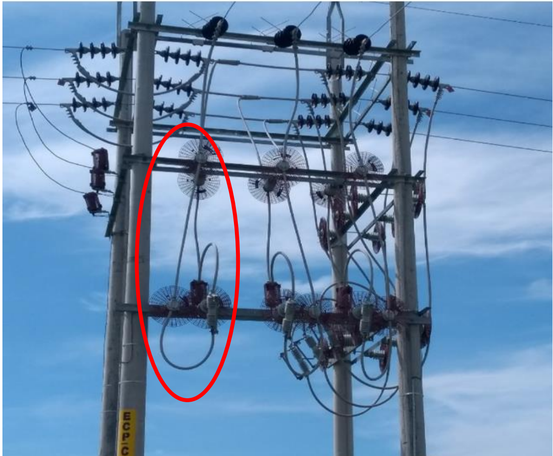
Fotografía 9. Protección Profauna instalado en Ecopetrol S.A.
