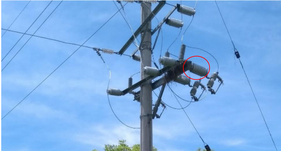
Fotografía 8. Aislador TR-210 instalado en Ecopetrol S.A.
