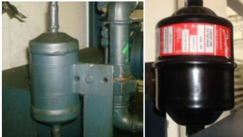
Figura 134. Cambio del Filtro del Chiller.
