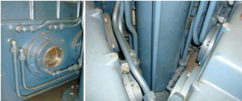
Figura 106. Tubería de los módulos de trabajo.
