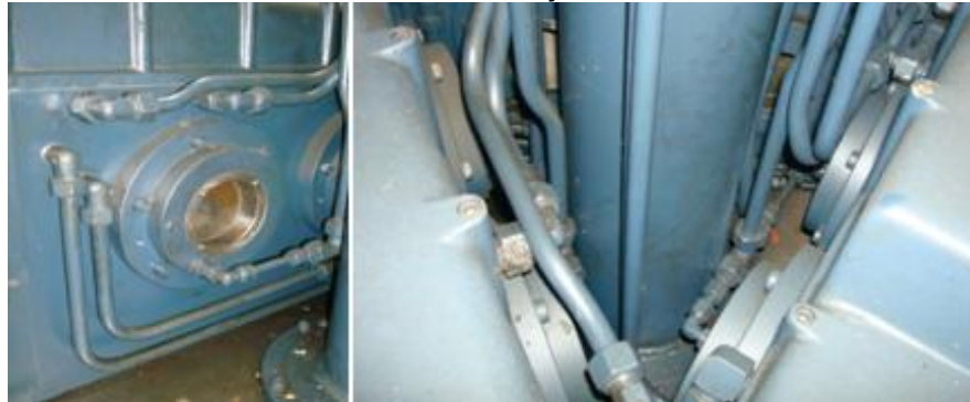
Figura 220. Tubería de los módulos de Trabajo.
