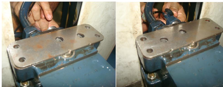
Figura 84. Placas en los manifolds mal montadas
