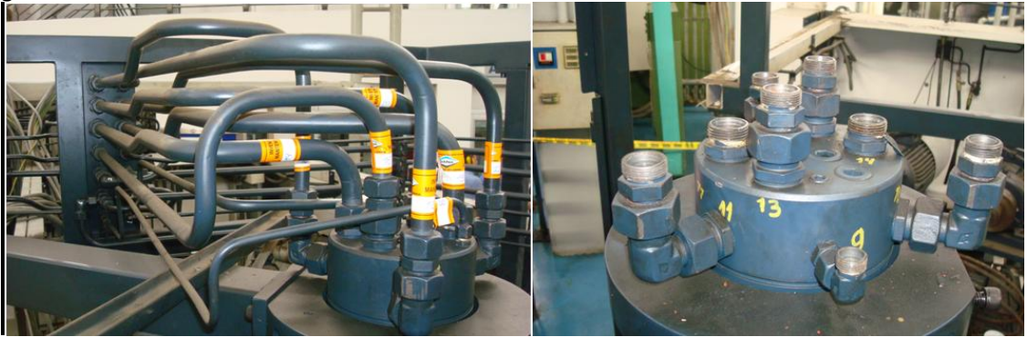
Figura 89. Conexiones de Tubería
