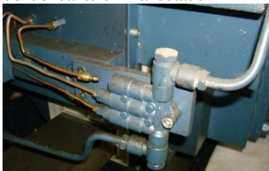
Figura 132. Inyectores de lubricante en mal estado.
