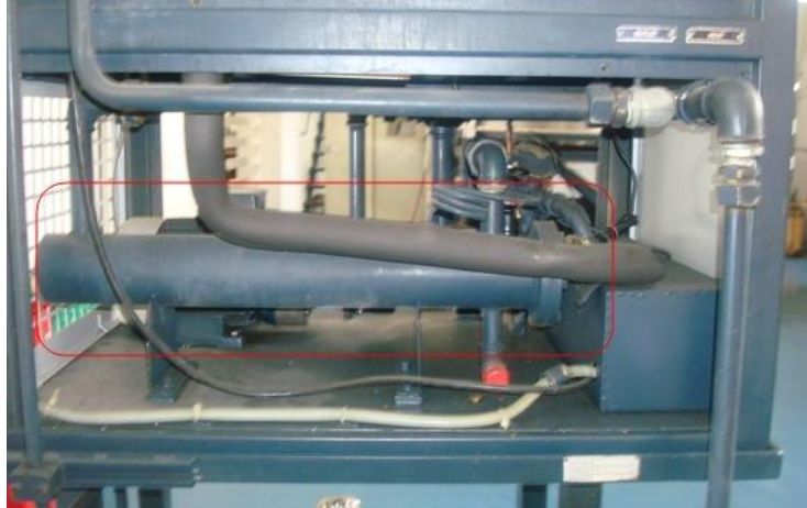
Figura 195. Evaporador - Intercambiador de Calor.
