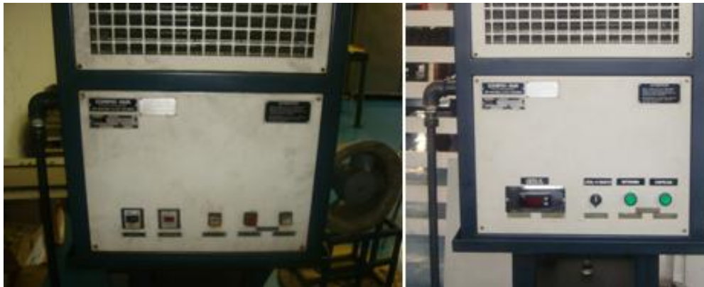
Figura 135. Cambio del Control del Chiller.
