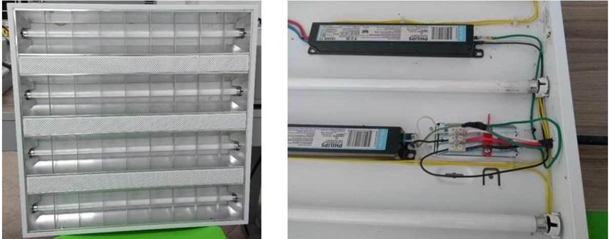
Figura 3. Luminaria On-Off y montaje de balastos.
