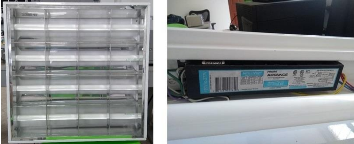
Figura 4. Luminaria dimerizable y balastro respectivo.
