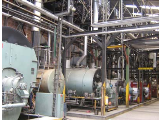
Figura 22. Cuarto de calderas.
