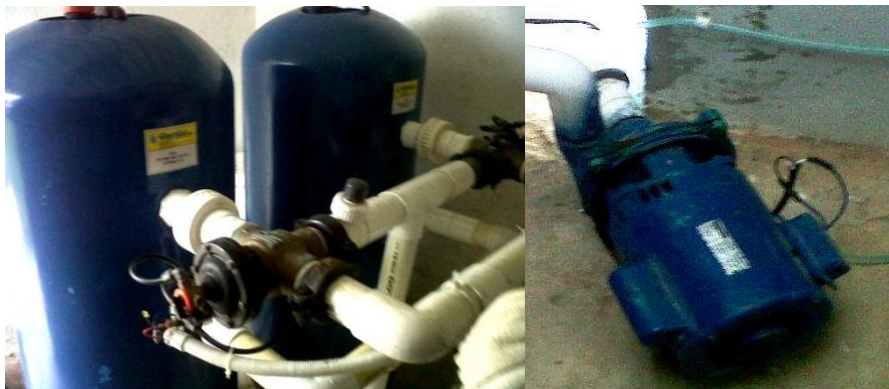
Imagen 10. Filtros arena/antracita Imagen 11. Bombas de filtración
