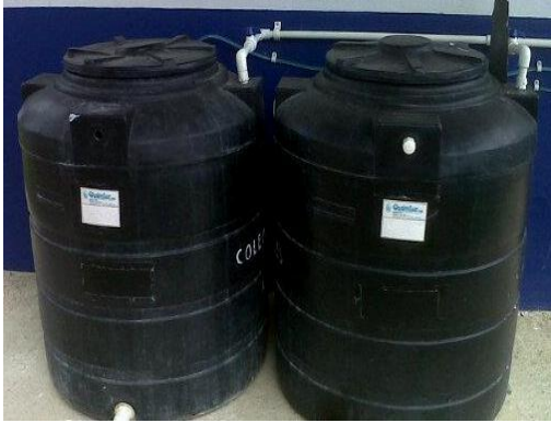
Imagen 12. Tanques de dosificación de químicos.
