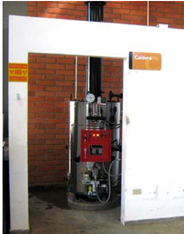
Figura 7. Cuarto de caldera
