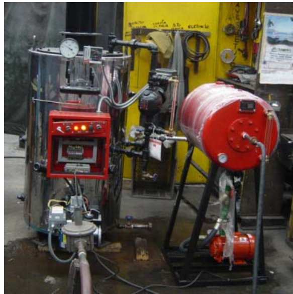
Figura 6. Caldera Tecnick 6 B.H.P con equipo de alimentación de agua
