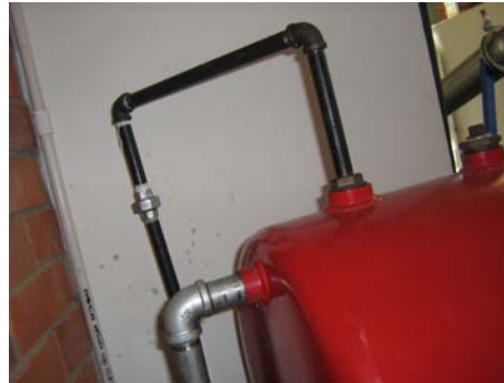
Figura 38. Tubería de retorno de condensados
