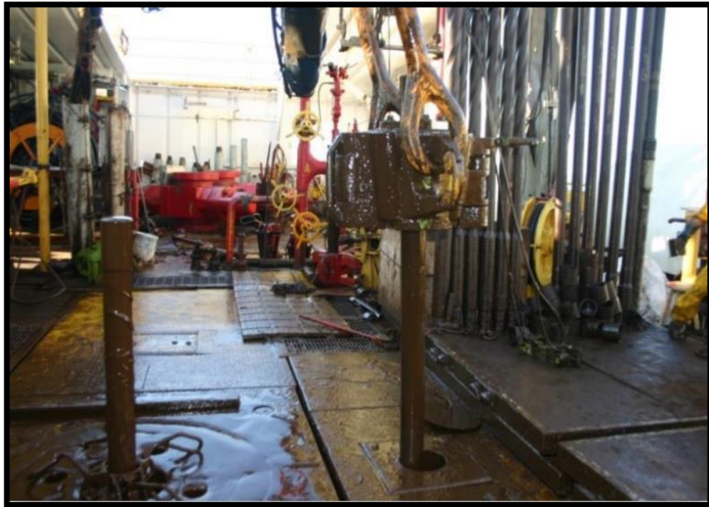
Figura 4. Piso de perforación.
