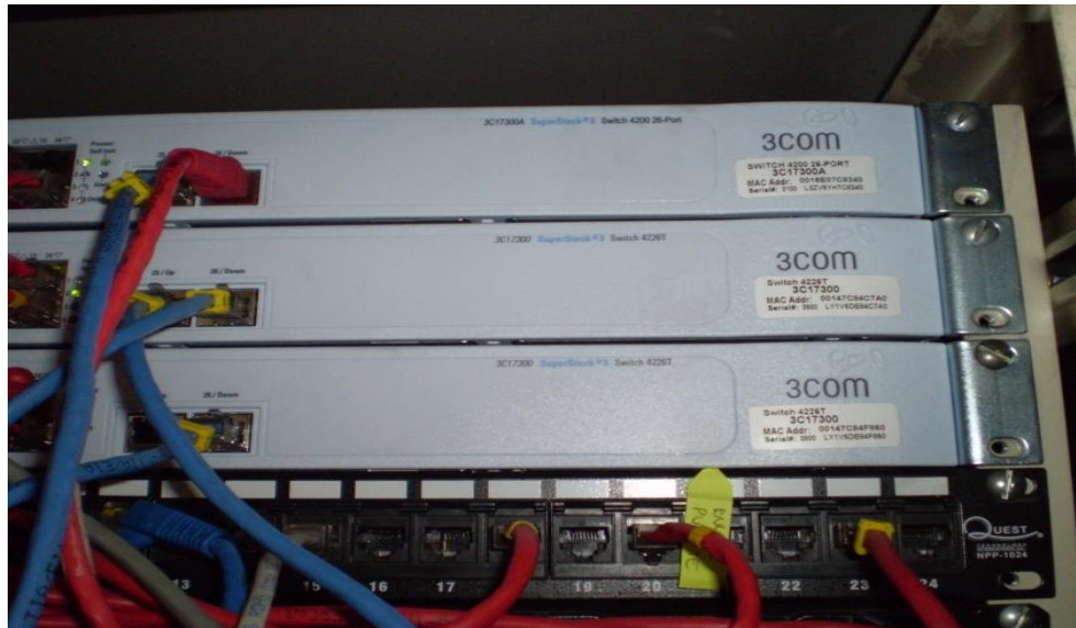
Figura 6. Apilamiento de Switch 3com 4226
