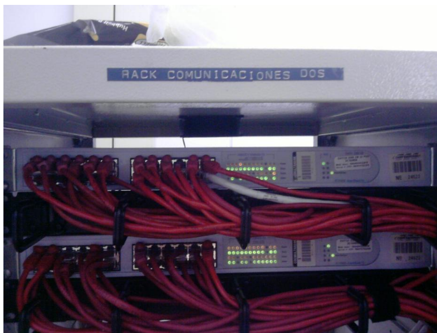
Figura 4. Rack de comunicaciones Piso 1
