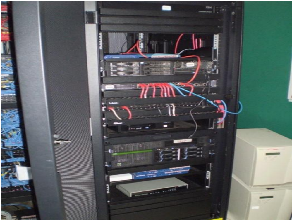
Figura 8. Segundo rack de comunicaciones y servidores piso 2
