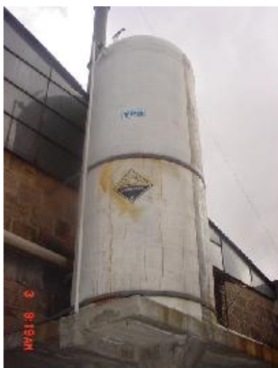
Figura N. 26. Tanque de ácido clorhídrico
