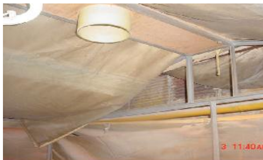
Figura N. 25. Extractor Zona de Acabado
