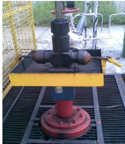
Figura 16. Cabezal de Pozo (Bombeo Mecánico)
