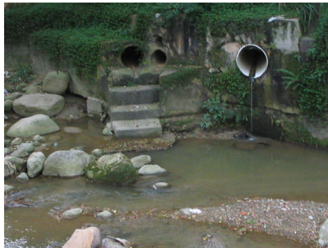
FOTO 4 IDENTIFICACION DE CONEXIÓN ERRADA BARRIO ASOVILAGOS FLORIDABLANCA
