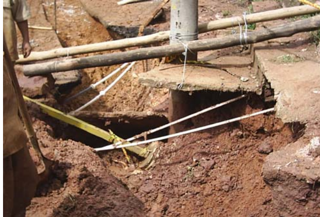
FOTO 3 DAÑO DE LA RED DEL ACUEDUCTO AL REALIZAR UNA REPOSICION
