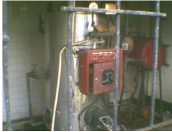
B - 2. 8. Generador de vapor
