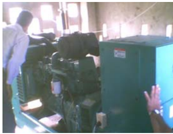
B - 2. 7. Generador de energía
