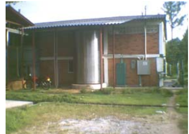
B - 2. 11. Tanque de almacenamiento
