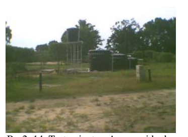
B - 2. 14. Tratamiento - Agua residual
