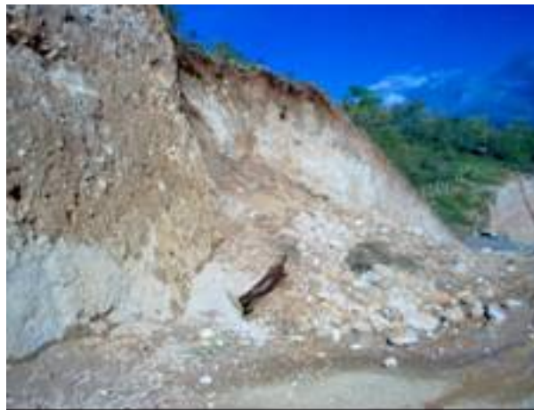
FIGURA 19. DERRUMBES EN LA VÍA
