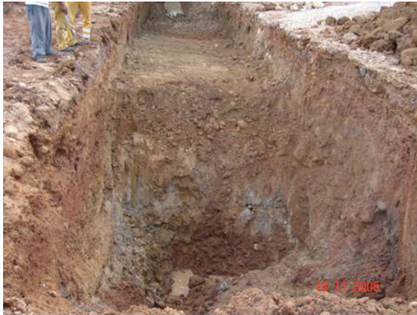
FIGURA 34. IMPREVISTO EN EXCAVACIÓN.
