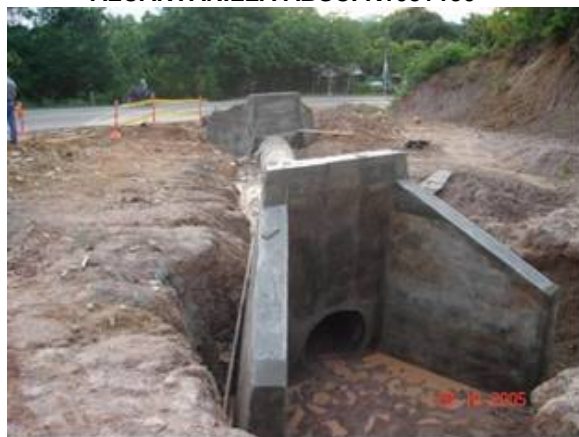
FIGURA 30 ALCANTARILLA ABSC. K103+130
