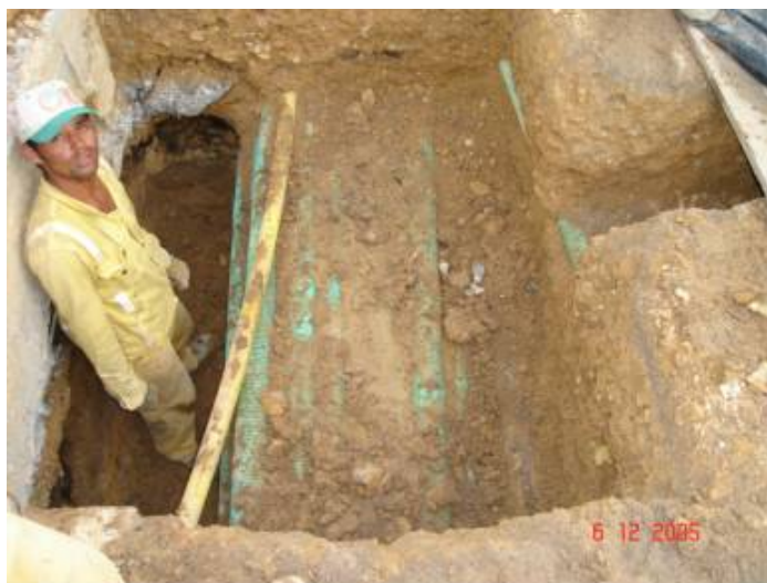
FIGURA 41. CAJA INSPECCIÓN CON TUBERÍA DE GAS
