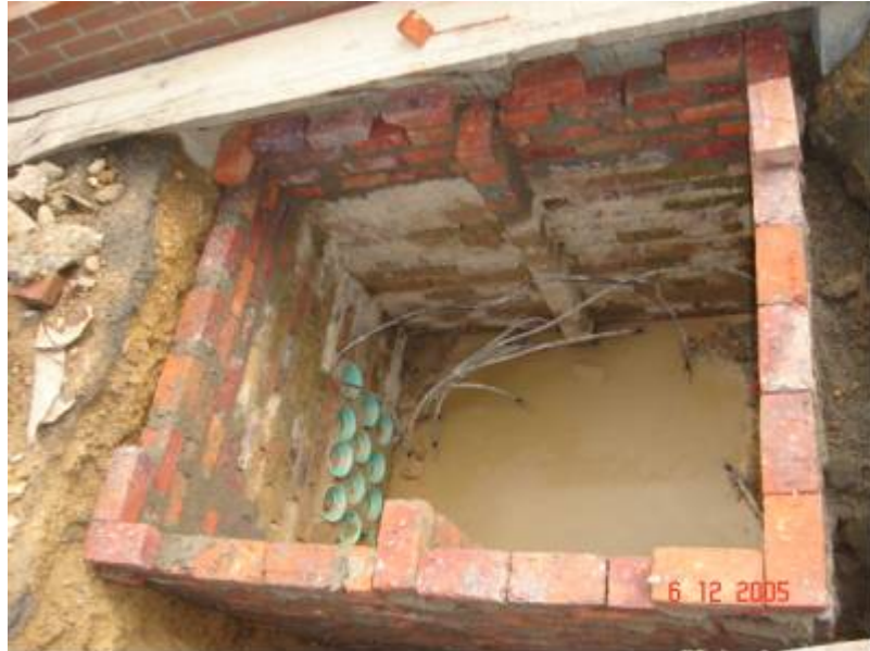
FIGURA 39. REMATES DE CÁMARA DE ENERGÍA
