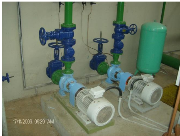
Figura 42. Sistema de Refrigeración
