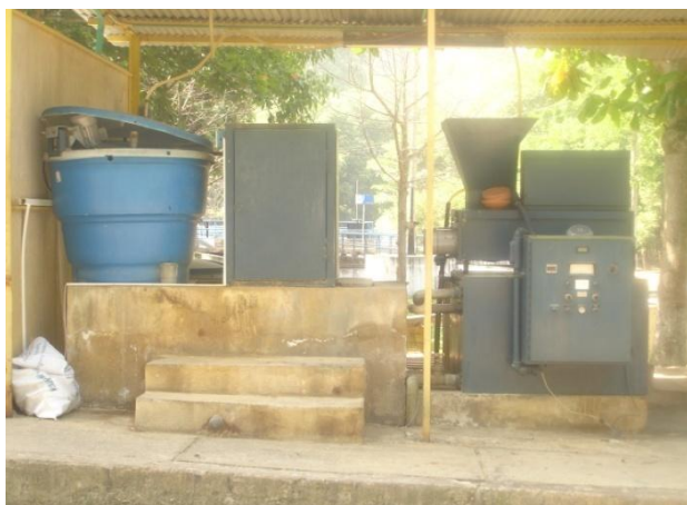
Figura 19. Equipos de Dosificación de Insumos Químicos
