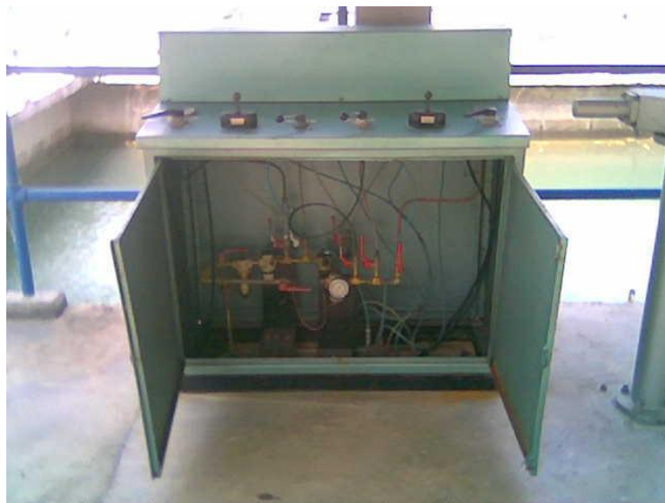
Figura 35. Mesa de Control de Filtros
