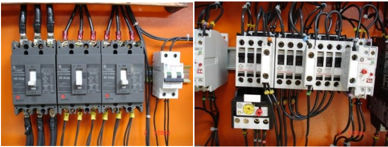
Fuente: A.M.B. S.A. E.S.P. Tableros de Control de Cloración
