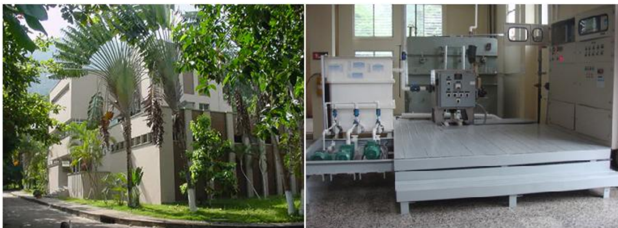
Figura 27. Edificio de Químicos y Equipos de Dosificación de Sulfato de Aluminio Líquido y en Solución
