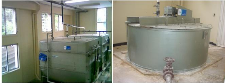
Figura 39. Equipos del Proceso de Estabilización
