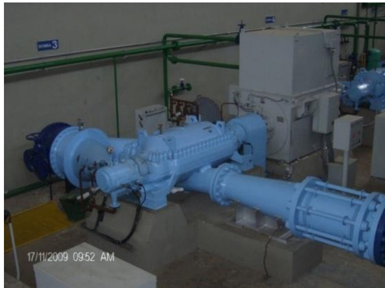
Figura 41. Vista General de la Unidad de Bombeo Principal
