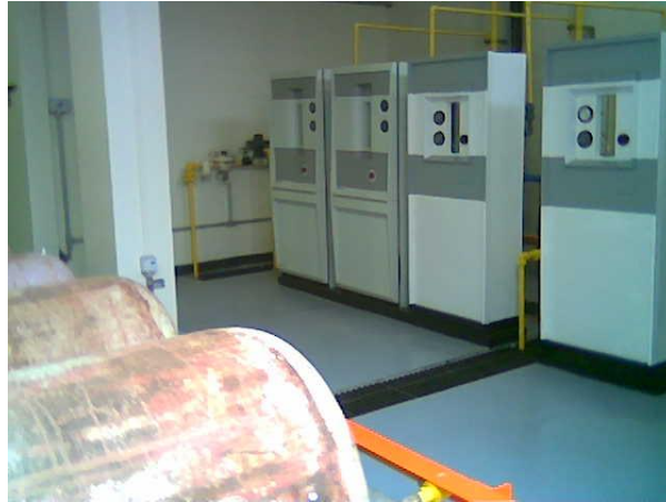
Figura 37. Cuarto de Cloración
