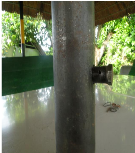
Figura 28. Vista lateral de la válvula de despresurización
