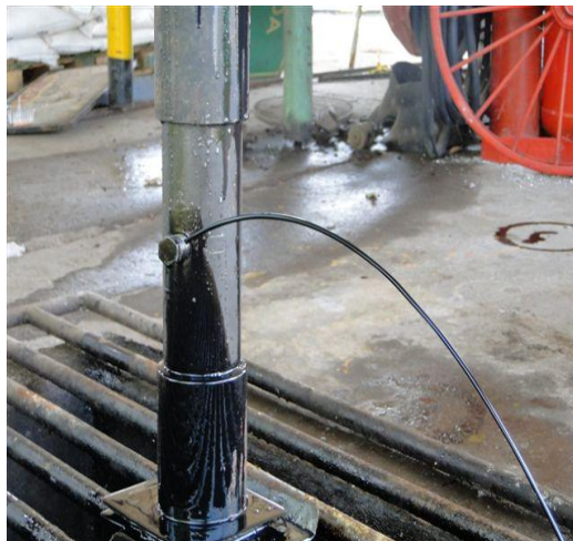
Figura 24. Válvula drenando Aceite a presión
