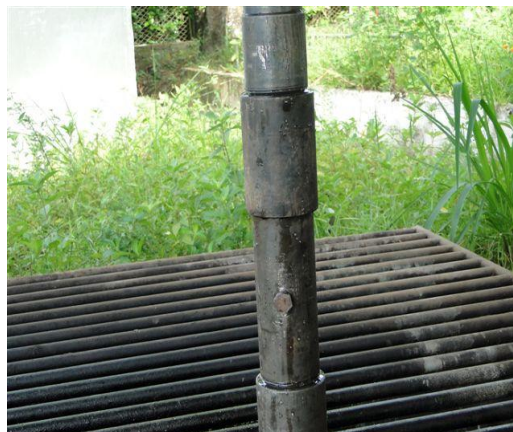
Figura 12. Válvula de despresurización cerrada
