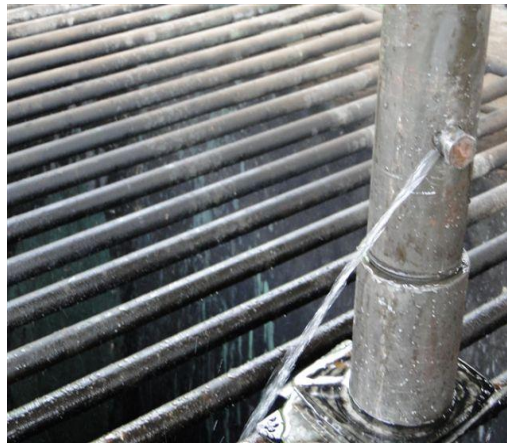
Figura 13. Válvula de despresurización abierta
