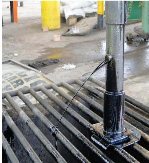
Figura 23. Cambio de fluido aceite gas
