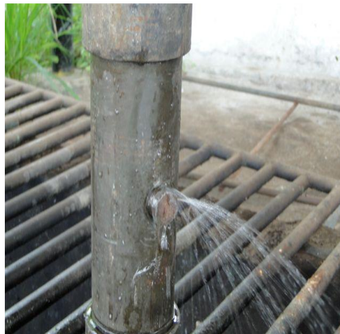
Figura 21. Válvula en operación despresurización agua y sólidos
