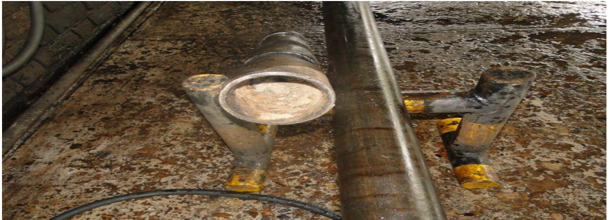
Figura 10 accesorios bomba desarenadora taponada por arena
