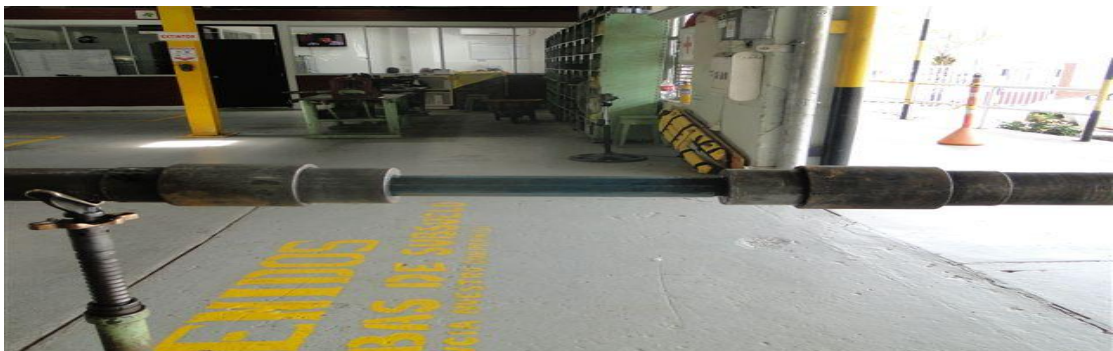
Figura 8 Bomba desarenadora en el taller de bombas
