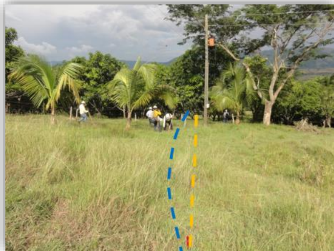
Figura 9. Rectificación de trazado para eludir poste eléctrico.
