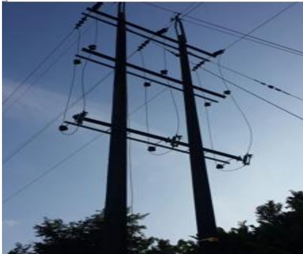
Figura 22. Seccionador monopolar tipo cortacircuito.
