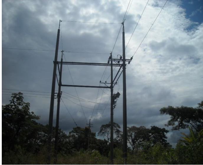
Figura 21. Estructura en concreto de dos postes.
