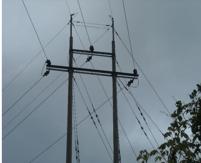
Figura 20. Estructura en concreto de dos postes.
