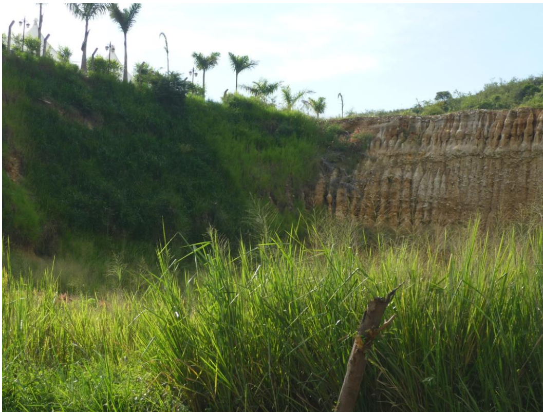
Figura 71. Afloramiento con manejo del talud para evitar grandes impactos en el proceso erosivo por esorrentía. Costado Norte vía Bucaramanga-Girón junto al Hotel San Juan de Girón.
