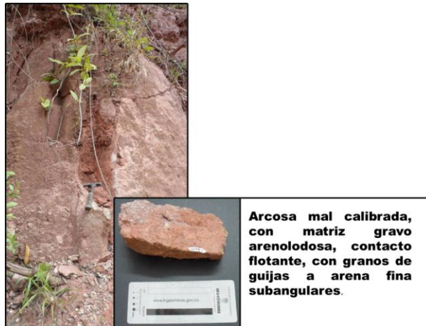
Figura 58. Imagen de detalle de roca caída compuesta por arenisca conglomerática color amarillo rojizo. Afloramiento ubicado sobre la vía antigua Bucaramanga-Floridablanca, cerca al Barrio Bucarica.
