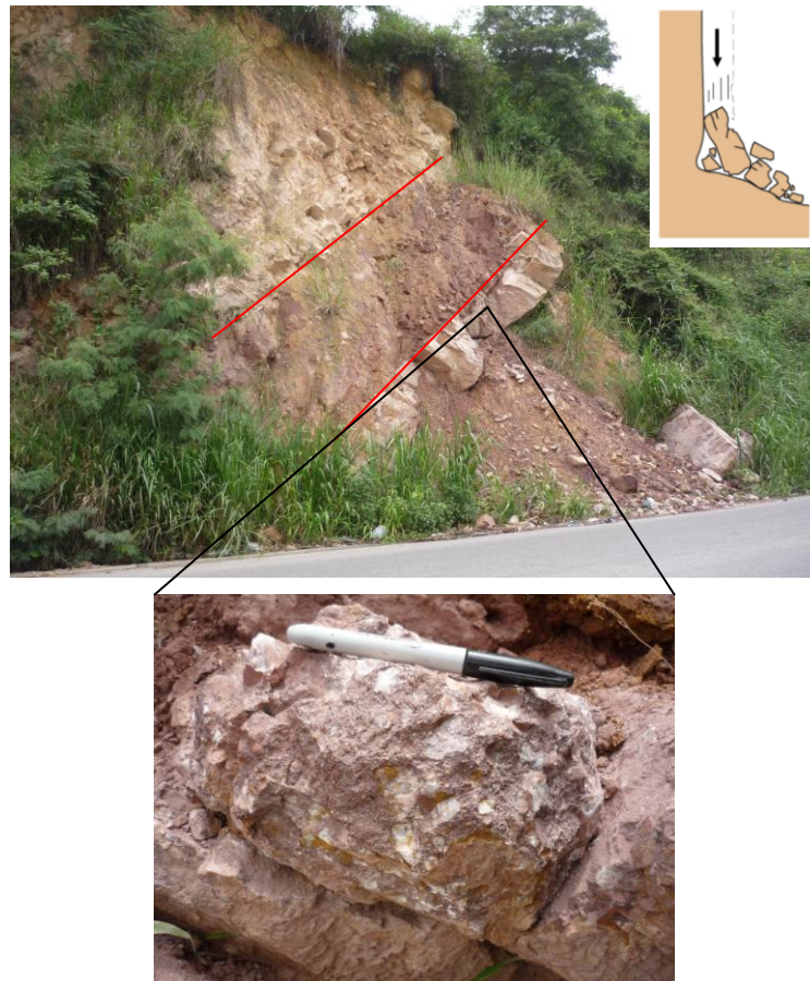
Figura 44. Vista del afloramiento ubicado frente al Colegio Metropolitano del Sur. Se observa movimientos de remoción en masa como caída de roca.
