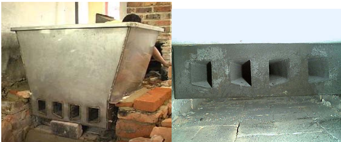
Fig. 2. Montaje de la paila pirotubular en la hornilla y detalle de la parte de dicha paila dentro del ducto.
