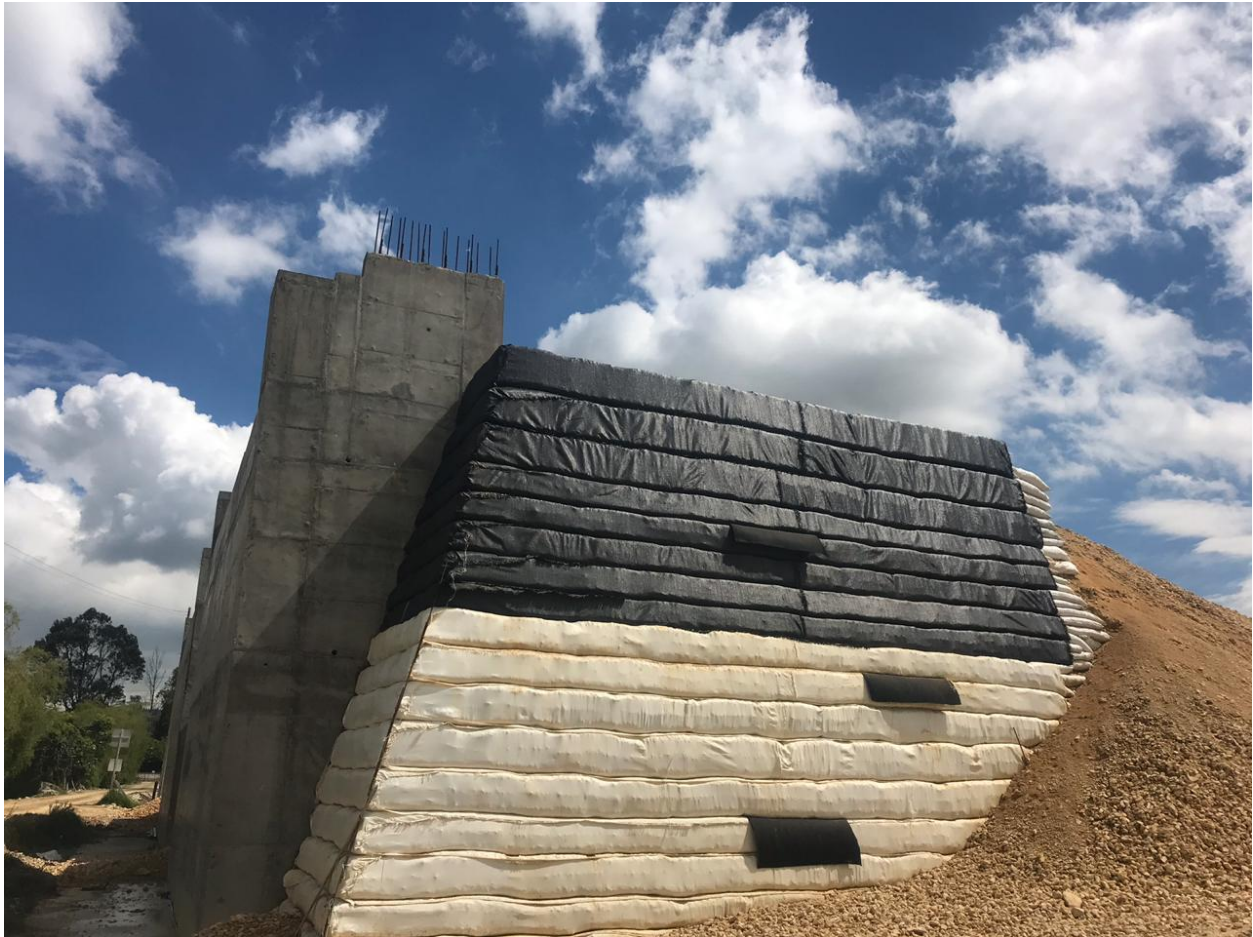
Figura 20. SME en Puente 4 estribo 2 calzada derecha al 20 de junio de 2019.
