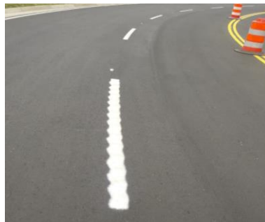
Figura 14. Falta de uniformidad de las líneas de demarcación vial.
