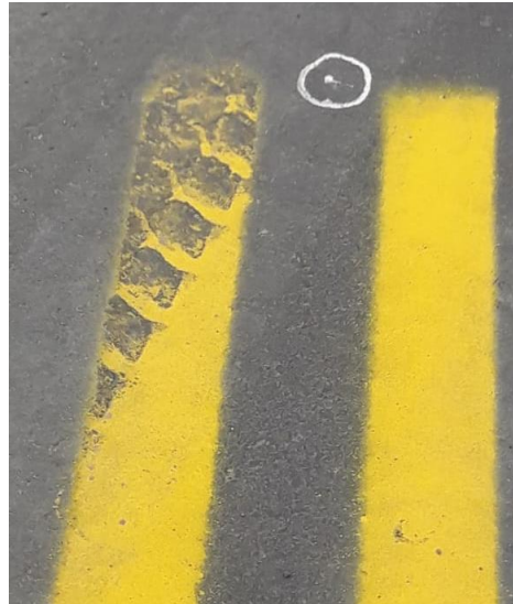
Figura 12. Línea camellón dañada por tráfico durante proceso de secado.
