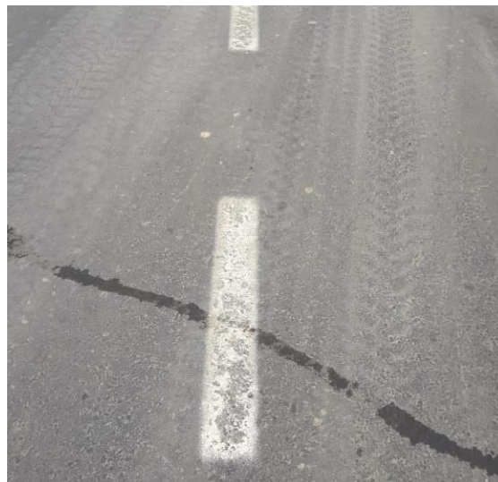
Figura 13. Desprendimiento de las líneas de demarcación horizontal.
