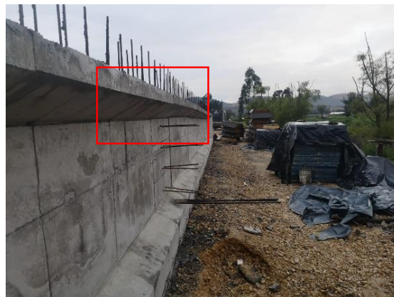
Figura 7. Zona afectada en el borde derecho de la viga No.1
