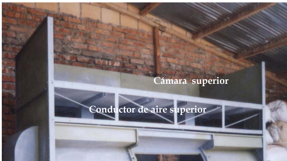
Figura 42. Cámara de secado superior y ductos para la descarga a la cámara inferior.
