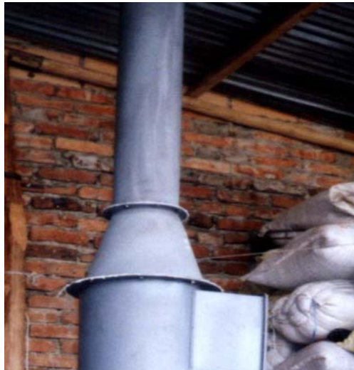
Figura 48. Chimenea para la salida de gases de combustión.
