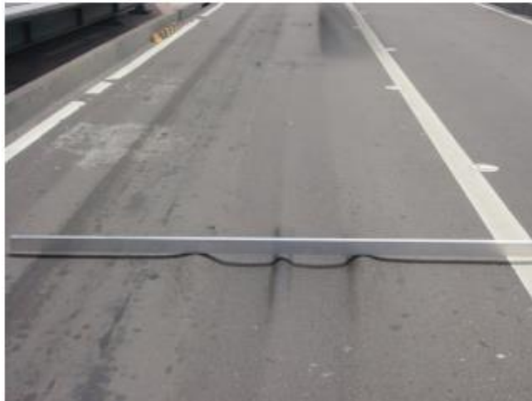
Figura 1. Formación de ahuellamiento, Calle 80 Bogotá, Colombia
