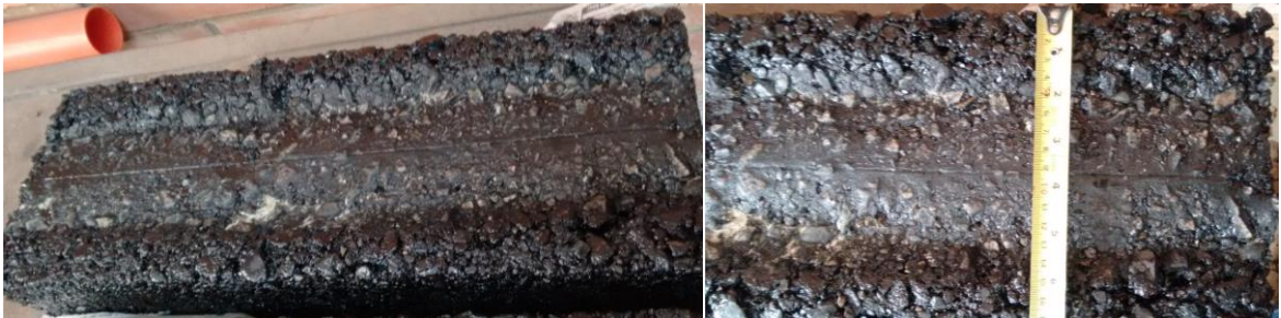
Figura 15. Vista de cerca del ahuellamiento formado en las probetas.
