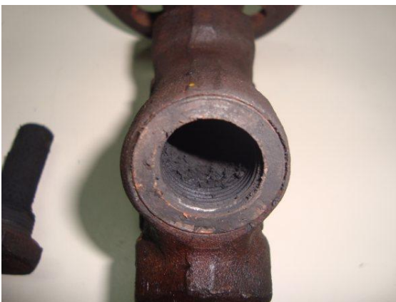
Figura 7. Ensuciamiento Interno de Una Trampa de Vapor (TV 03-135).
