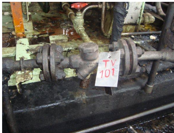
Figura 6. Identificación de trampas de vapor mediante placas metálicas.
