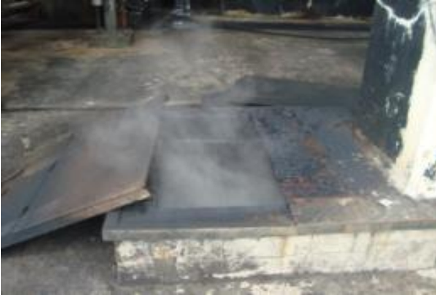
Figura 13. Descarga de vapor constante de trampa ubicada en E-2515C.
