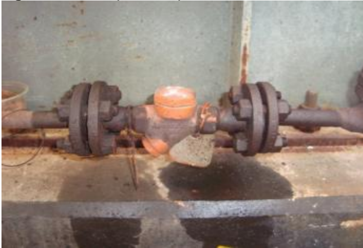
Figura 11. Trampa de vapor ubicada en E-2515 C.
