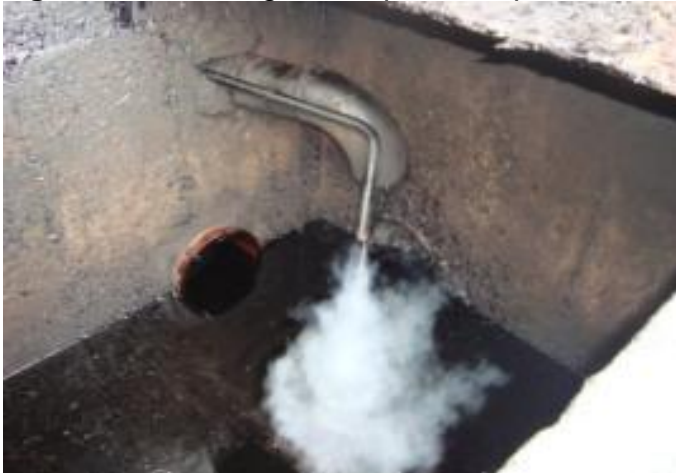
Figura 12. Descarga de vapor Trampa E-2515C.
