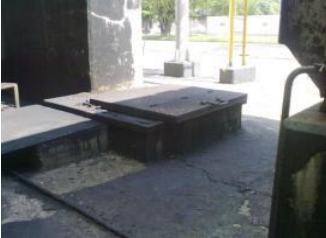
Figura 15. La disminución de vapor es evidente en la descarga de la trampa.
