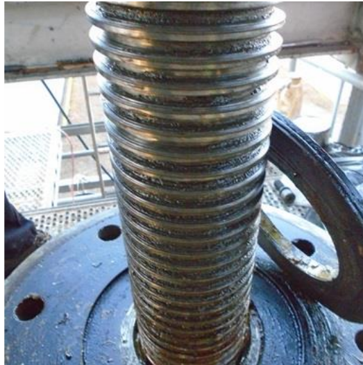
Figura 3. Desgaste del vástago de la válvula
