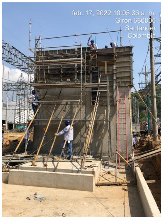
Figura 17. Muro cortafuego del transformador T5.
