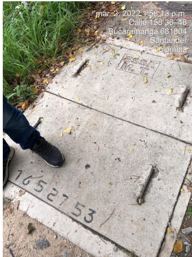
Figura 23. Caja de inspección eléctrica ESSA.
