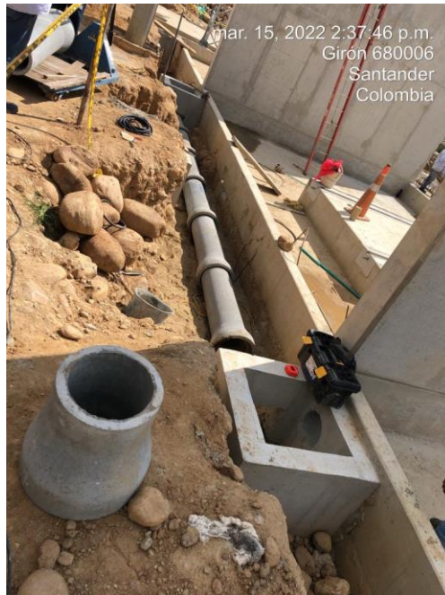
Figura 20. Caja del gancho de tiro y drenaje del aceite del transformador T3.
