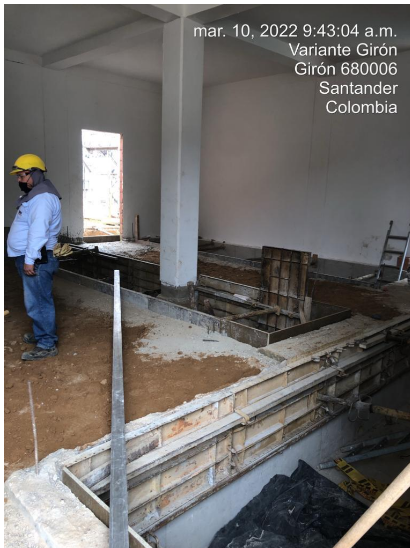
Figura 14. Cárcamos de control.
