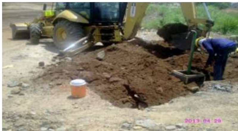
Foto tomada cerca a la estación de servicio de la mina, realizando el relleno y la instalación de la estación de prueba.
