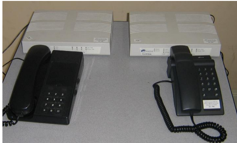
Fotografía 1. Teléfonos tradicionales y Equipos Quintum Tenor ASM-200.
