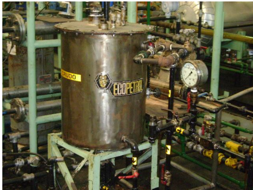
Fotografía 1. Tanque de Almacenamiento de Mezcla Crudo-Solvente
