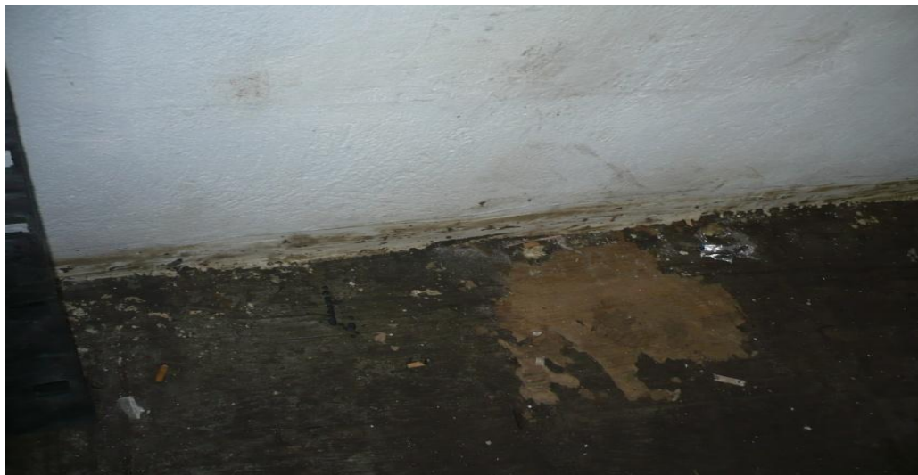
Fotografía 1. El depósito de archivo presenta deterioro en la infraestructura; se evidencian signos de humedad. 25 ENERO 2011
