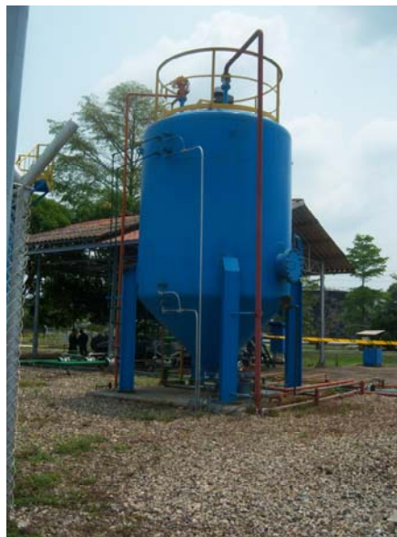
Figura 29. Decantador de sólidos ST-711
