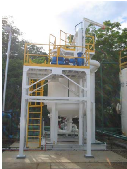
Figura 14. Filtro de lecho
