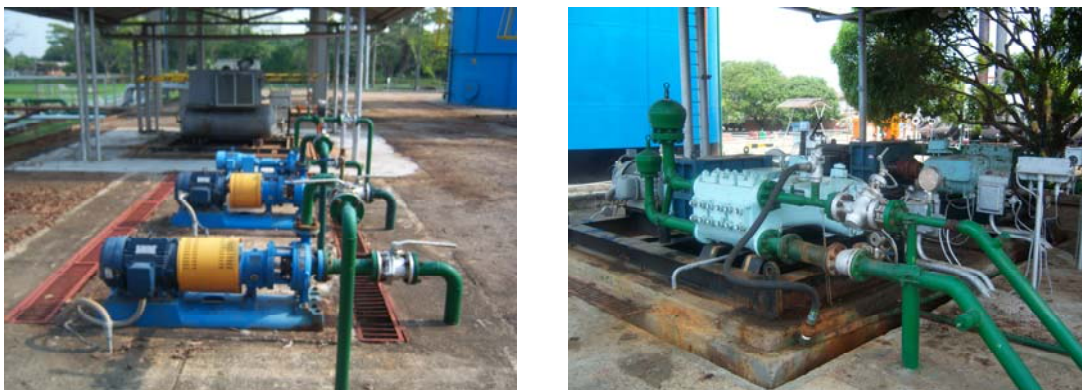
Figura 32. Bombas booster P-713 A/B, Sand-jet P-713 C y de inyección P-714 A/B
