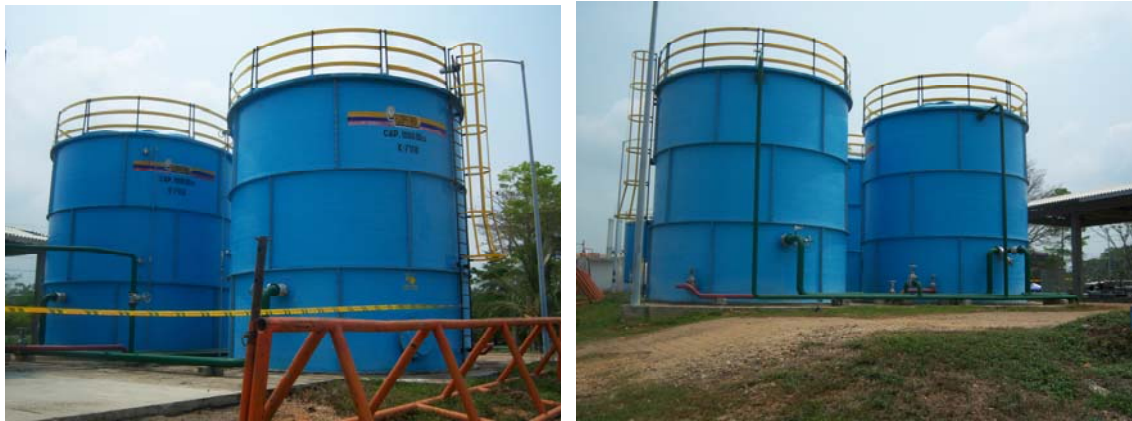
Figura 26. Tanques de estabilización K-711 A/B
