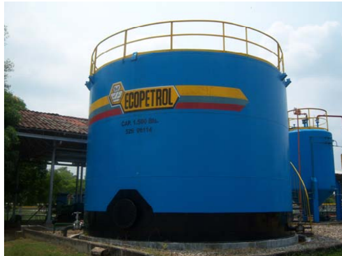
Figura 31. Tanque de almacenamiento de agua filtrada K-712
