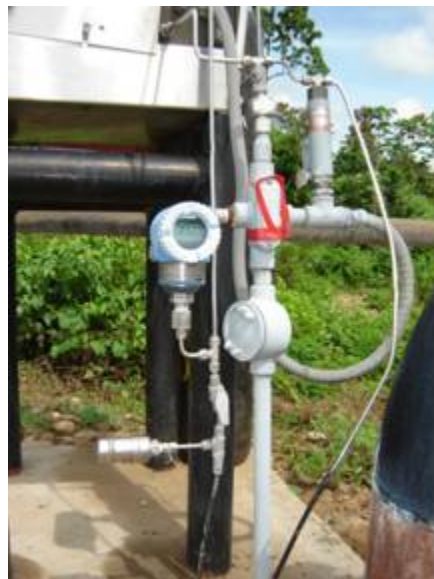
Figura 10. Switch de Presión ubicado en la Subestación de un Pozo.
