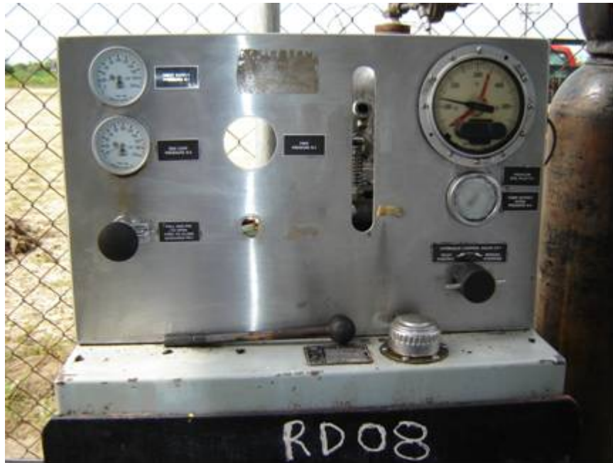
Figura 15. Vista frontal del tablero de control de un Panel OTIS
