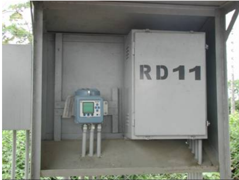
Figura 12. Conexión del NOC a la RTU.
