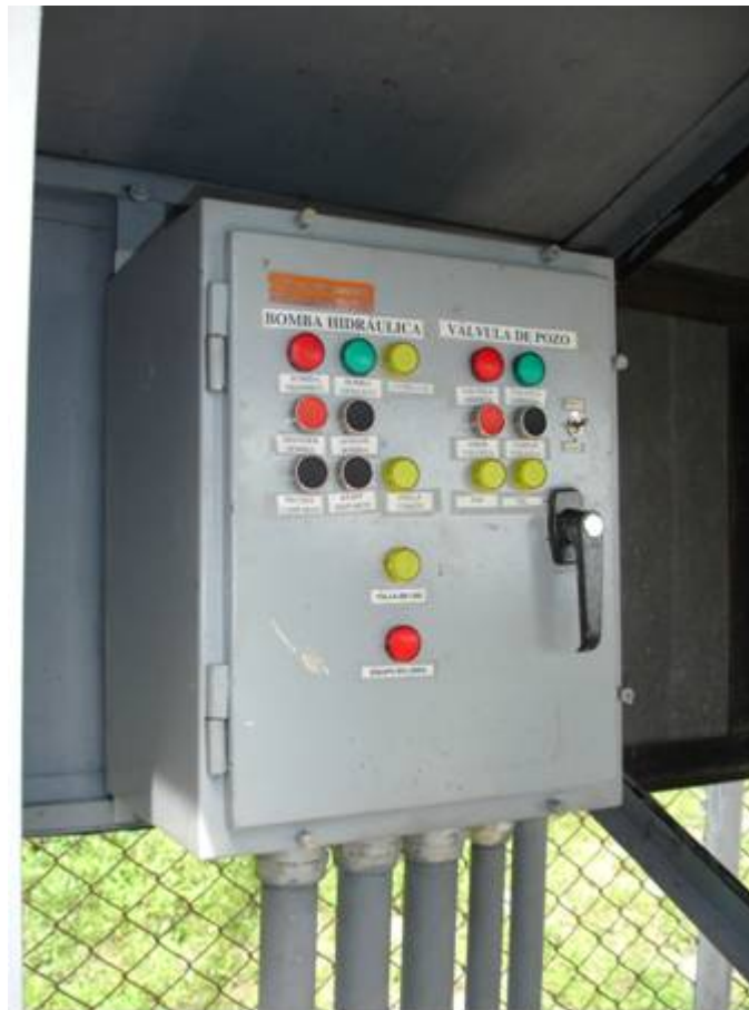
Figura 18. Nuevo sistema de comunicaciones del Panel OTIS modificado.
