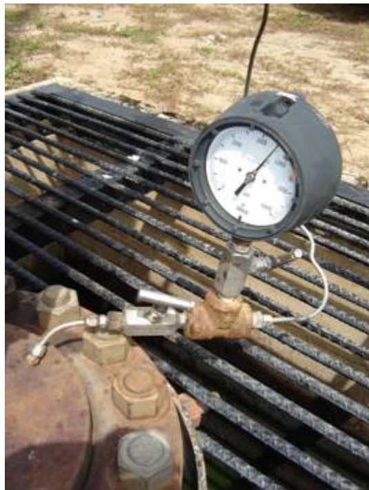
Figura 16. Manómetro de presión ubicado en la cabeza de pozo.
