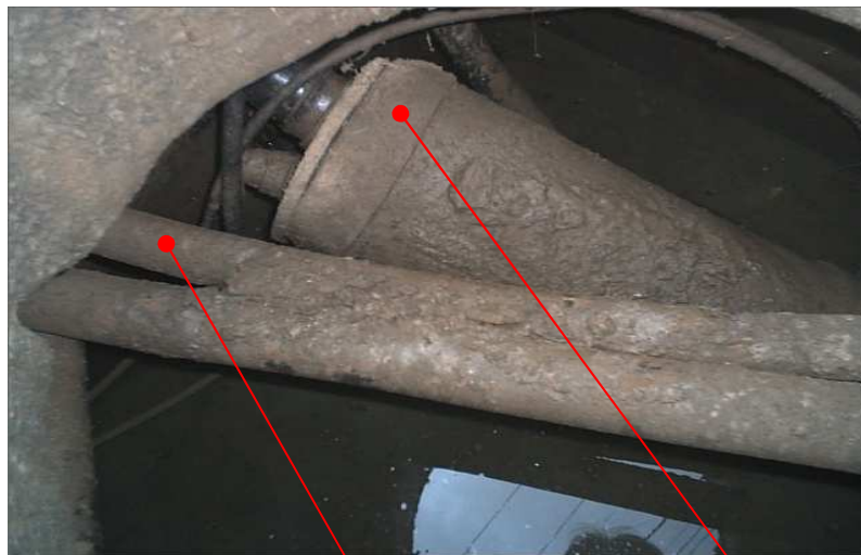
Fig. 27 Cámara Telefónica sin mantenimiento.
